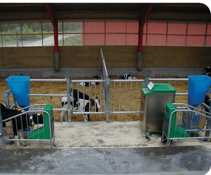
Afløbsrist sørger for at der er tørt omkring drikkestationerne
